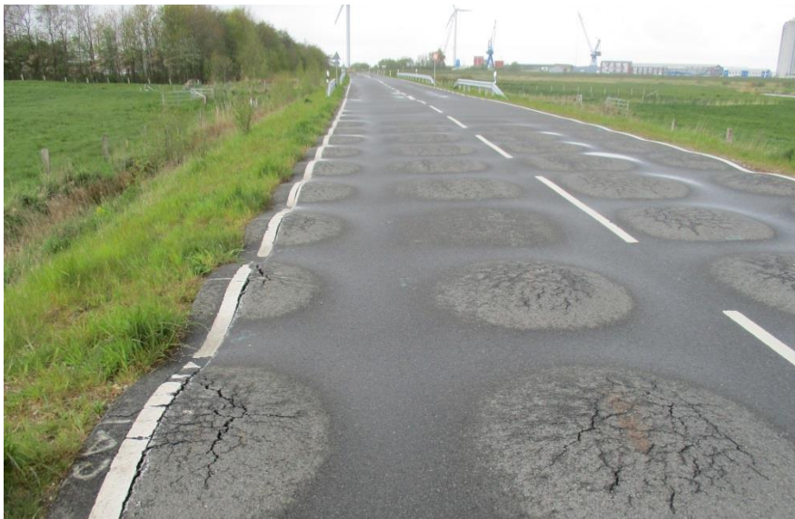
Abbildung 28: Schadensbild im Bereich der Beton-Säulen (April 2015)
